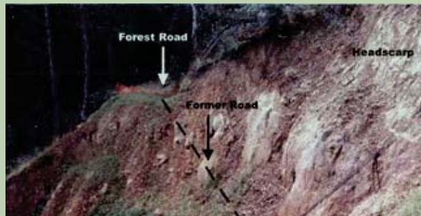
شکل ۵- تخریب جاده بر اثر زمین لغزش (ارسکین، ۲۰۰۵)
