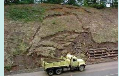
شکل ۳- ناپایداری دیواره خاکبرداری جاده (لويس و همکاران، ۲۰۰۱)
